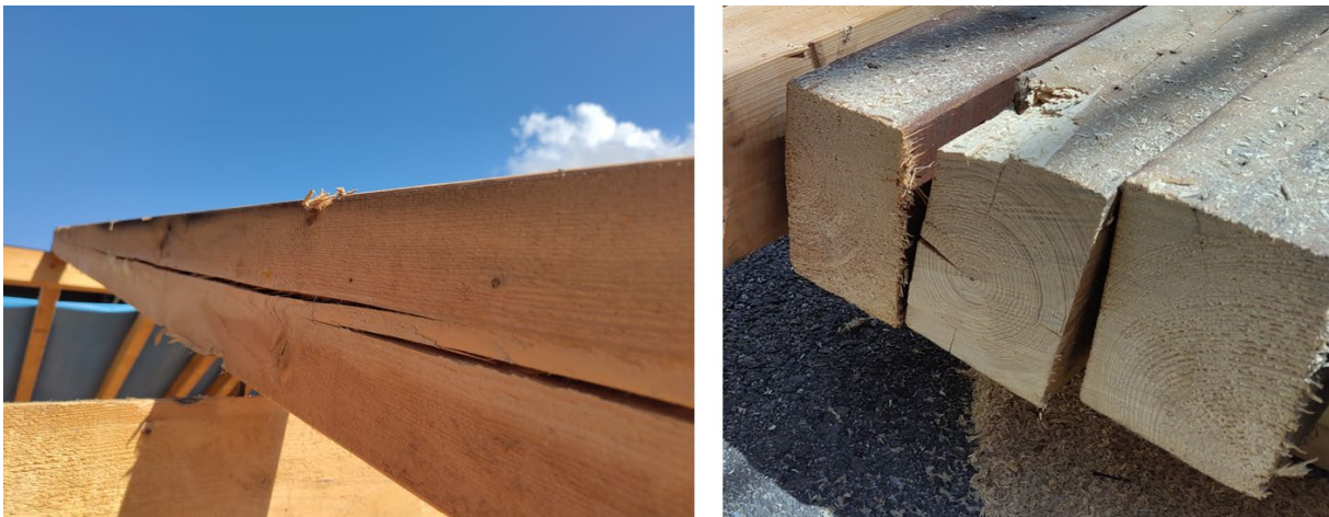
Abbildung 41: Risse in den rückgebauten Sparren durch das Schwindverhalten von Holzbalken mit Markröhre oder Streifmark (Fotos P. Fuchs, BFH)
