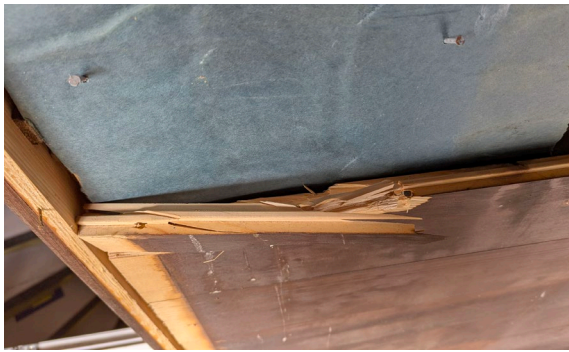
Abbildung 34: Rückbauschaden und erschwelter Ausbau durch die gute Befestigung der Aussen-Holzverkleidung mit verzinkten Nägeln (Foto M. Arnold, OLWO)
