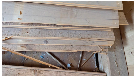
Abbildung 29: Rückbauschäden an Kamm und Nut der Holzverkleidung (Foto M. Arnold, OLWO)
