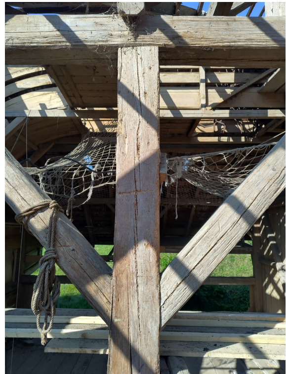
Abbildung 25: niedrige Qualität von Altholz durch Risse, nicht-rechteckige Balkenquerschnitte und Schäden durch Insektenbefall (Foto P. Fuchs, BFH)
