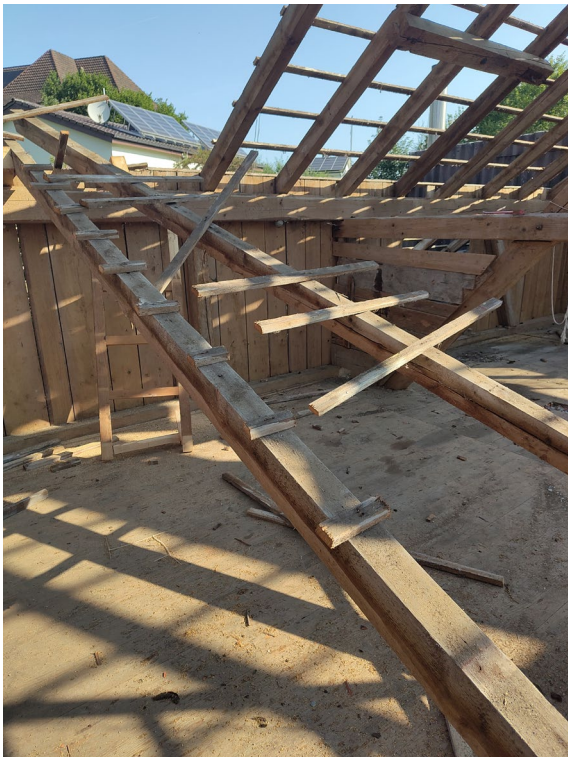
Abbildung 24: abgetrennte Sparren mit Dachlattung (Foto P. Fuchs, BFH)
